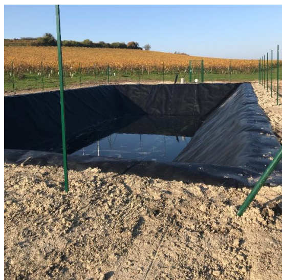
Photo n° 9 : le bassin à vinasses de 450 m 3
